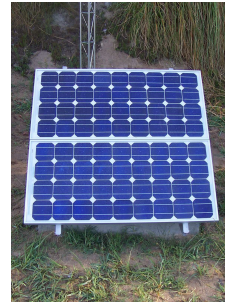
2) grupo solar fotovoltaico
