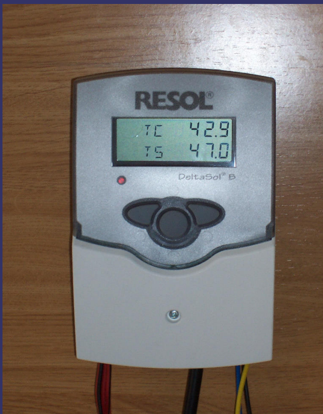
Centraliña de control
