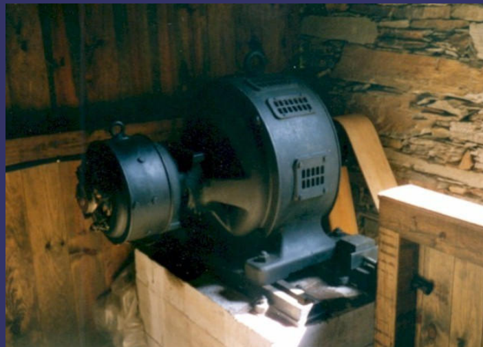
Alternador empregado para a produción eléctrica na ferreiría de Bogo (A Pontenova)
