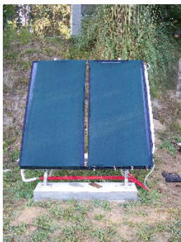
1) grupo solar térmico
