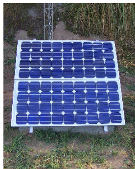
2) grupo solar fotovoltaico
