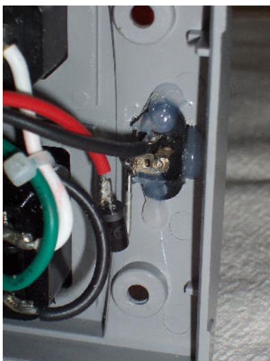
Conector de entrada en la parte posterior del SAI. Puede verse el diodo soldado en el cable.
